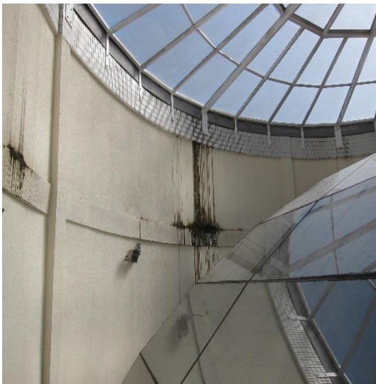
Foto 12 – Vestígios de vazamento no interior da cúpula
