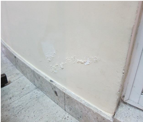
Foto 32 – Formação de empolamento na alvenaria interna
