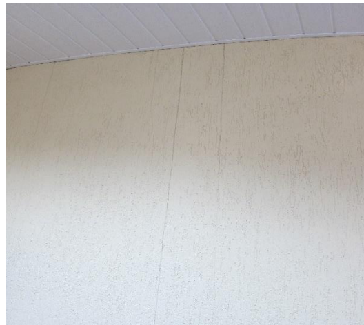
Foto 33 – Infiltrações de águas pluviais em alvenaria interna
