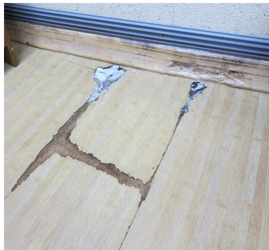
Foto 35 – Piso interno danificado devido à infiltrações
