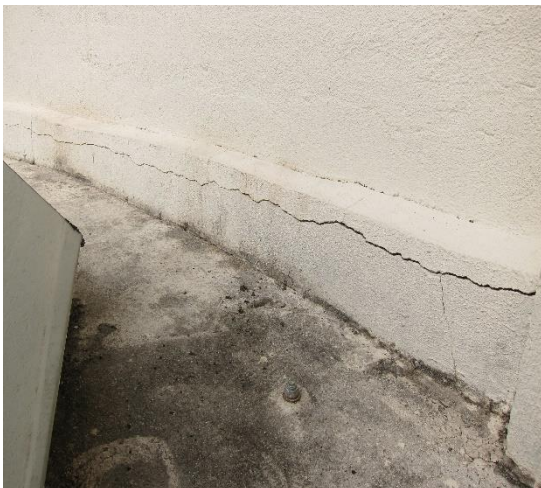
Foto 24 – Formação de trincas no reboco da viga
