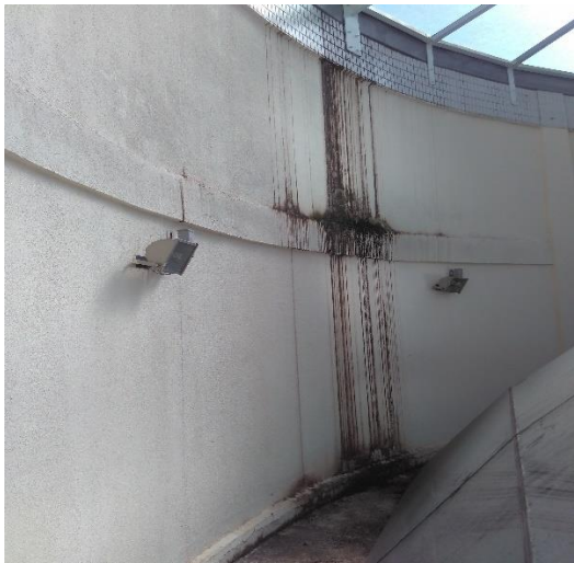
Foto 16 – Infiltração de águas pluviais no interior da cúpula
