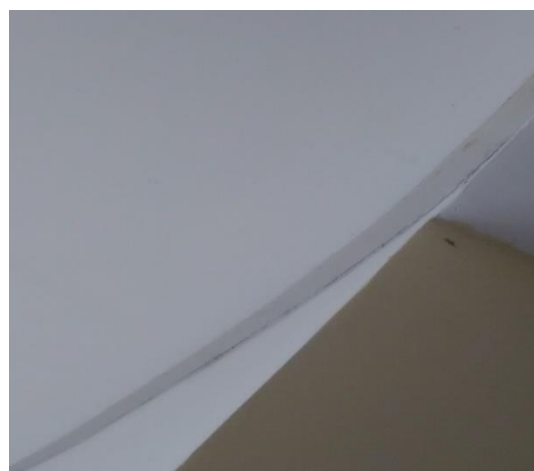
Foto 37 – Descolamento do gesso abaixo da estrutura
