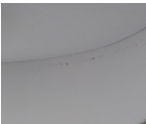
Foto 36 – Formação de fissuras abaixo da estrutura
