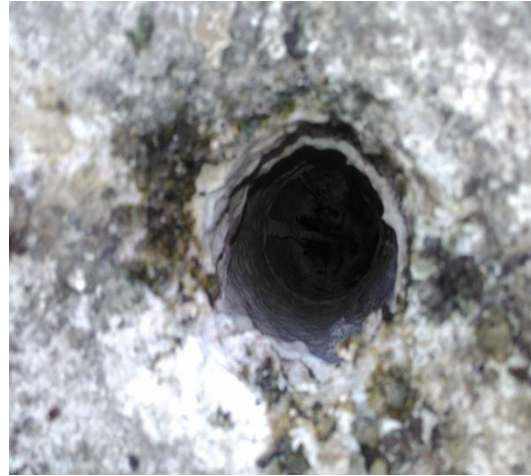
Foto 29 – Detalhe do sistema pluvial da Cúpula
