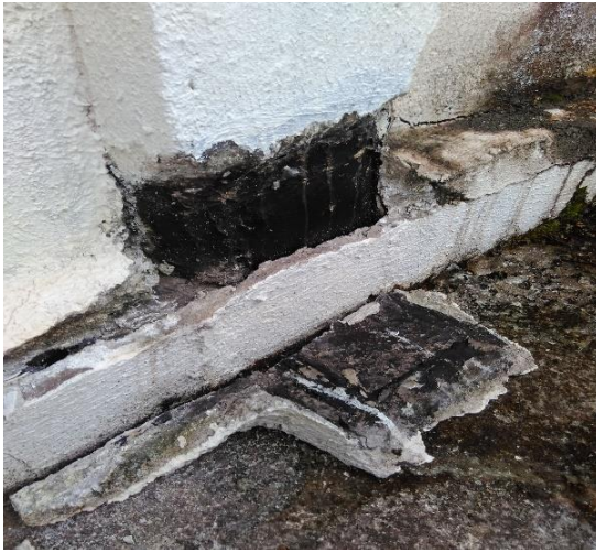
Foto 22 – Destacamento do reboco do pilar
