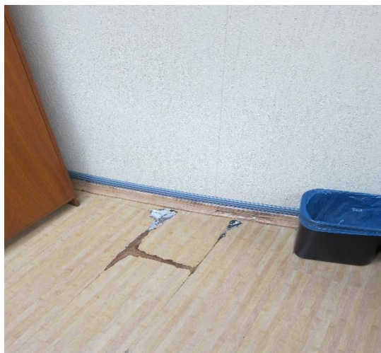
Foto 34 – Piso interno danificado devido à infiltrações
