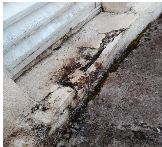
Foto 25 – Formação de trincas e manchas de umidade na estrutura
